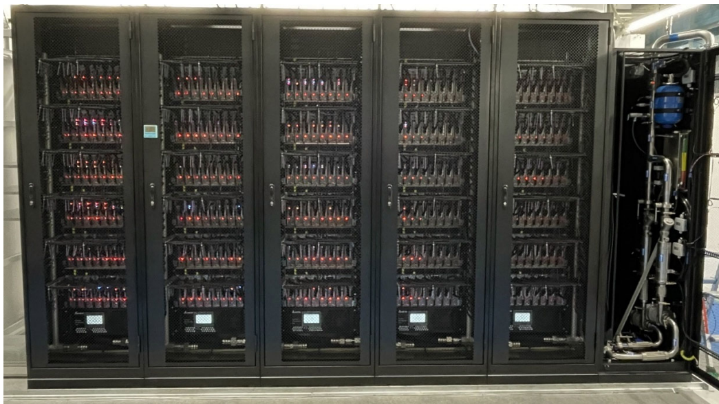
松江DCPに設置された直接水冷のMN-Core 2サーバ30ノードおよび水冷設備
