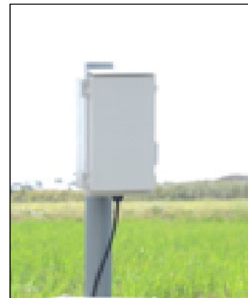
自動給水弁 通信ボックス
