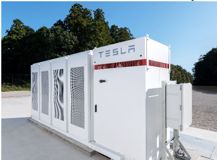
(写真) 白井データセンターキャンパスに設置した Powerpack
