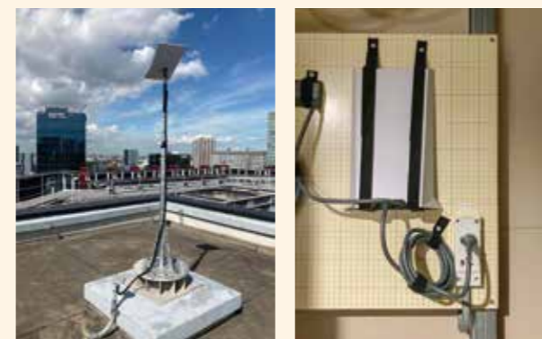
屋上のアンテナ
