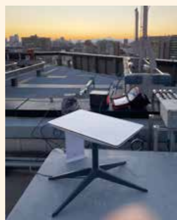
ビルの屋上に仮設置した様子
