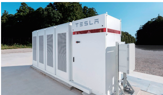
図-16 白井DCCに設置済みのPowerpack
