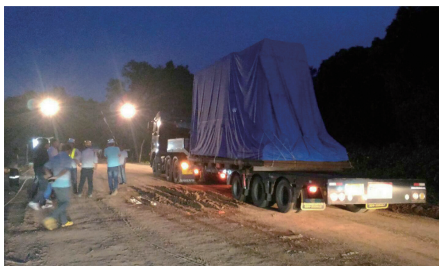
図-2 コンテナ第1号到着 ～日中の作業時間を確保するため夜間輸送実施～
