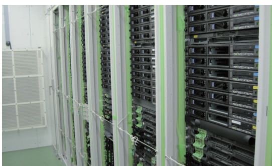
図-10 ラック間を養生テープで目張りし空調効率を高める
