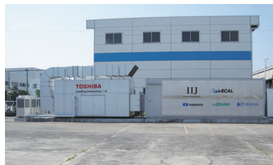
図-9 左から、室外機、空調モジュール、ITモジュール
